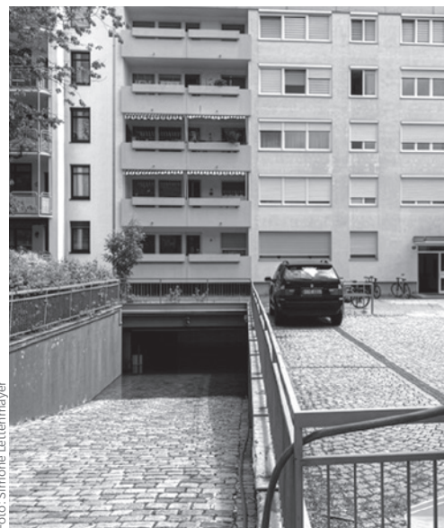
Überschwemmte Tiefgarage nach Starkregen
