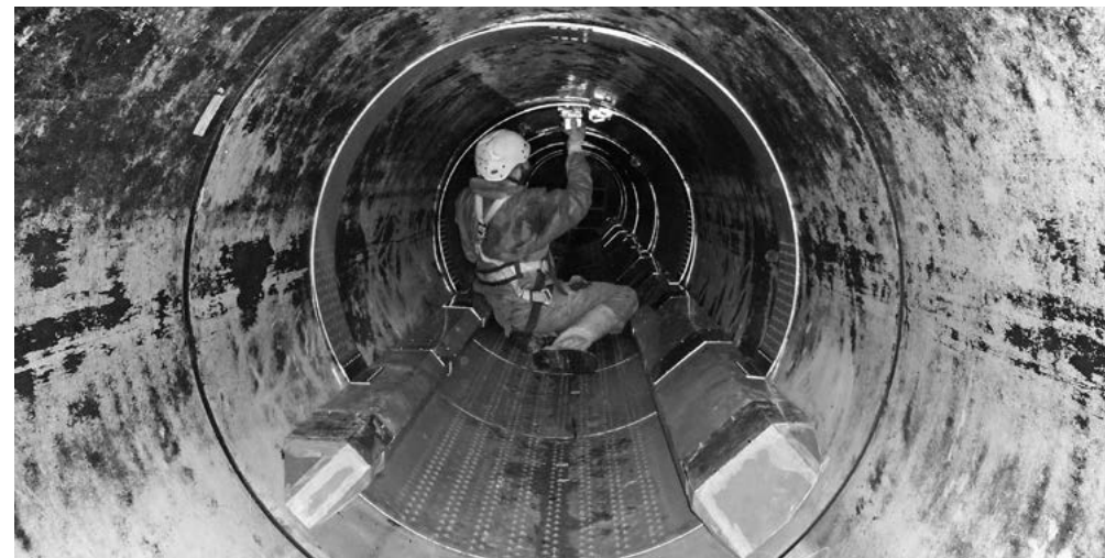
Ein Pionier bei der Wärmegewinnung aus Abwasser ist das baden-württembergische Unternehmen Uhrig. Sein Wärmetauschsystem „Therm-Liner“ wurde bereits in über 100 Kanälen installiert.
