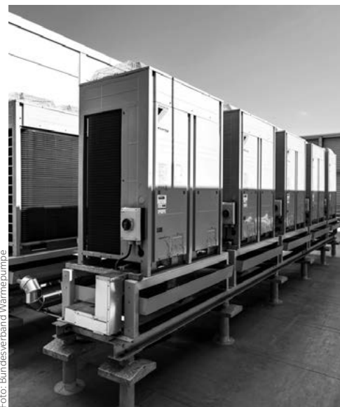
Große Wärmepumpenanlage für ein Gewerbegebäude
