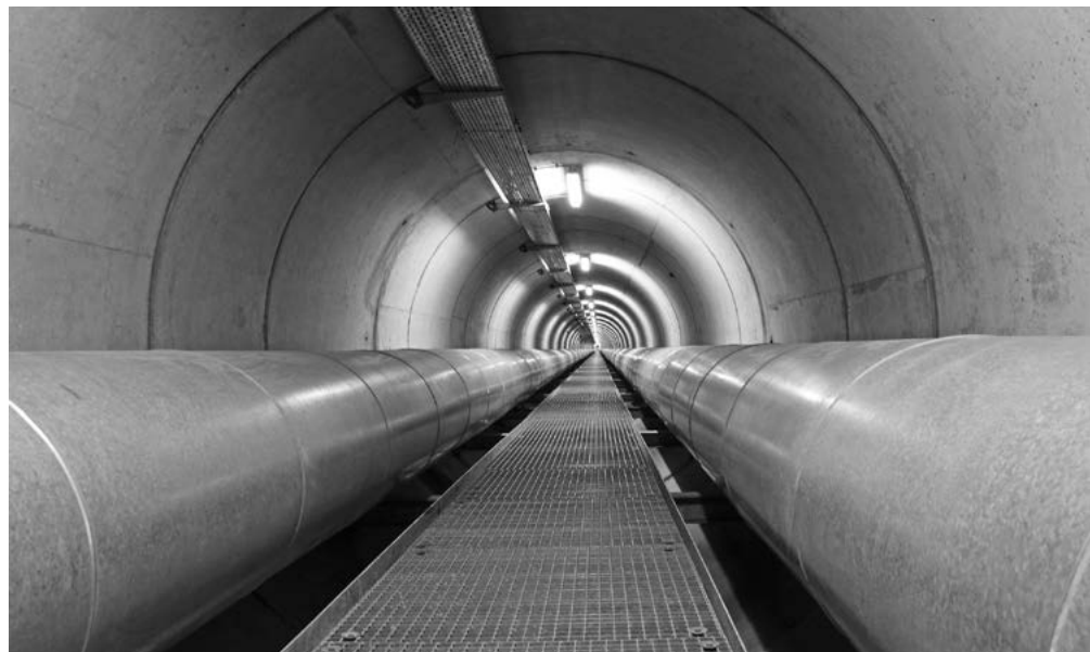
Fernwärmeleitungen in einem Tunnel unter dem Rhein in Köln
