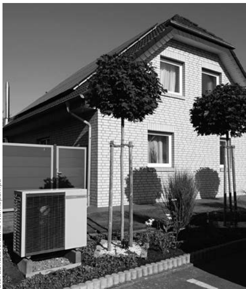
Kleine Wärmepumpenanlage für ein Einfamilienhaus
